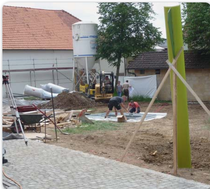
Hier die Anlage mit der Seilbahn und dem Bodentrampolin für die Großen.
